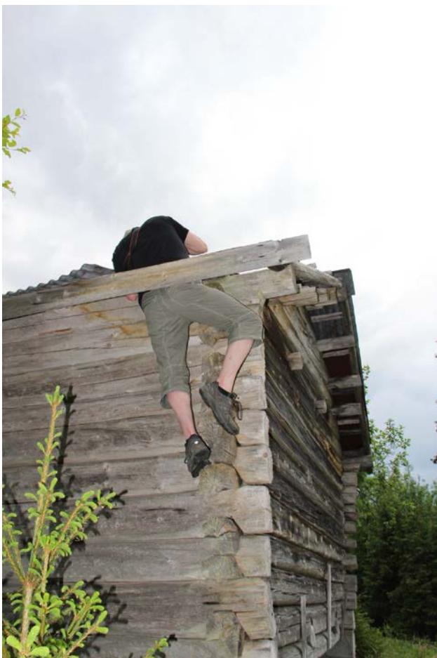
Bo Hansson forsøker å reparere ødelagt tak på bua i Fallåsen
